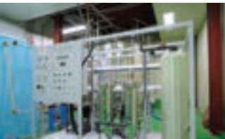
R/O 정수기 / R/O Water purifier R/O 净水器
